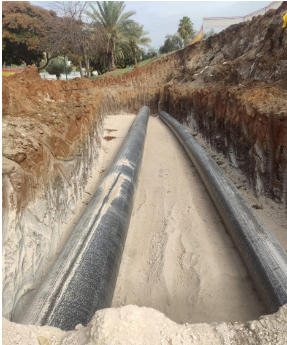
פריקט תחנת קווי סניקה מלוד דרך רמלה למ"ש אילון | צילום: באדיבות אפיקי תבור
